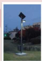
太陽光 パネル付 LED照明灯
